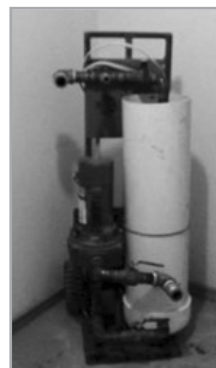
Vakuovací jednotka (nebo odvzdušňovací jednotka)
